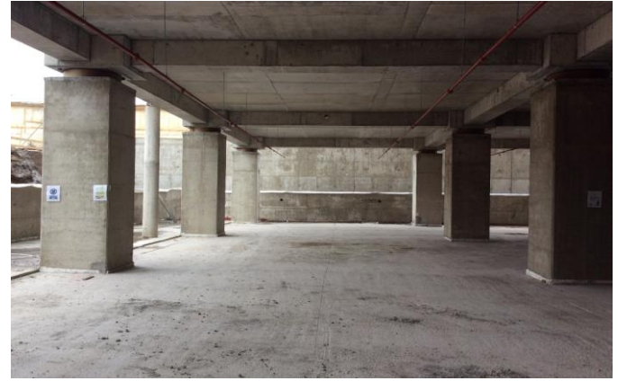
Dispositivos instalados en edificio TH
